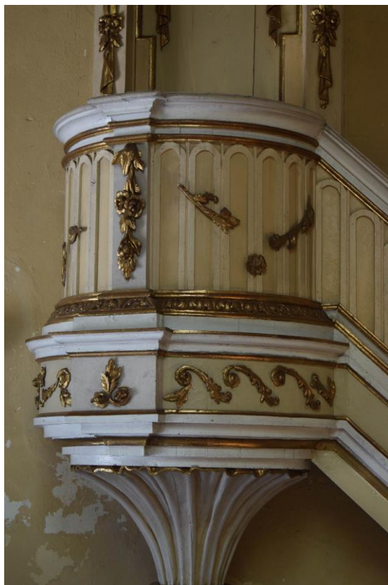
Fot. 18. Kosz ambony z widocznymi pęknięciami drewna i ubytkami ornamentów.
